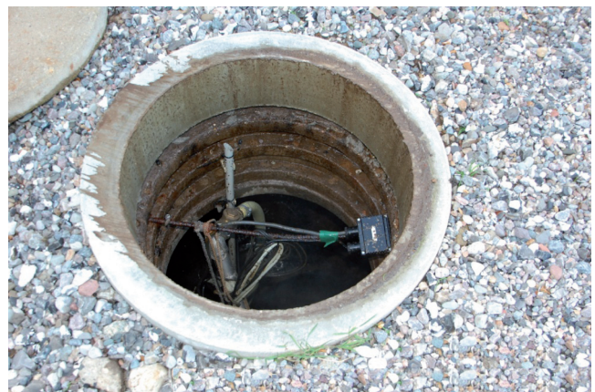
Bild 6: Kondensatschacht Biogasanlage: mögliche Gefahr CO 2
